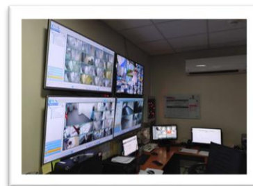
SALA DE CONTROL
